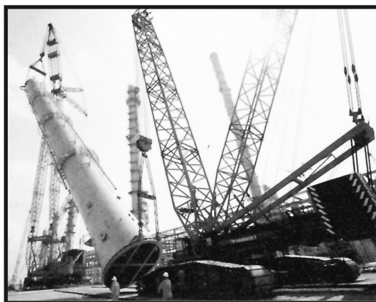
Mammoet přepravil a instaloval více než 60 dílů s hmotností od 50 do 900 tun pro obnovu petrochemické rafinerie v Elefsisu, Řecko, použitím pásových jeřábů, SPMT a přídavných zařízení. Staveniště bylo malé a úzké a hned vedle fungující rafinerie.
