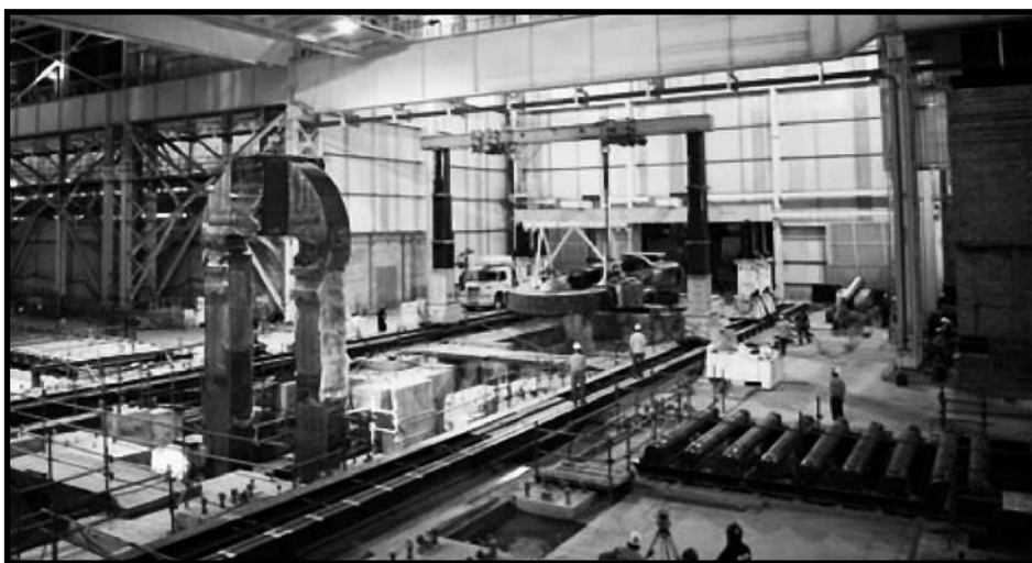
Část válcovací stolice je upevněna na portálový jeřáb a připravována na instalaci.
