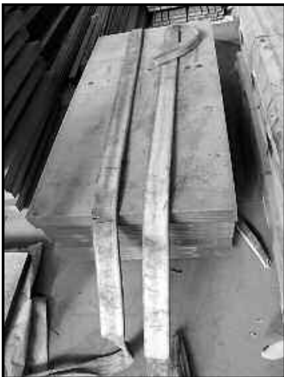
kontrolované pracoviště – v době vzniku pracovního úrazu Davida P. používané dva textilní popruhy OKO-OKO s nasazenými ochrannými návleky
