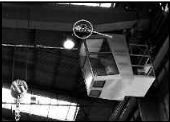
kontrované pracoviště – symboly vyznačené na konstrukci mostového jeřábu Vihorlat Snina VÚDÚT VT-1 (rok výr.: 1991; nosnost: 5000 kg) označující směry pohybů uvedeného jeřábu
